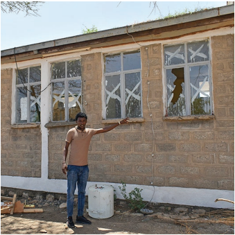
Derbew Abebaw montre les vitres cassées des postes sanitaires endommagés pendant le conflit.
